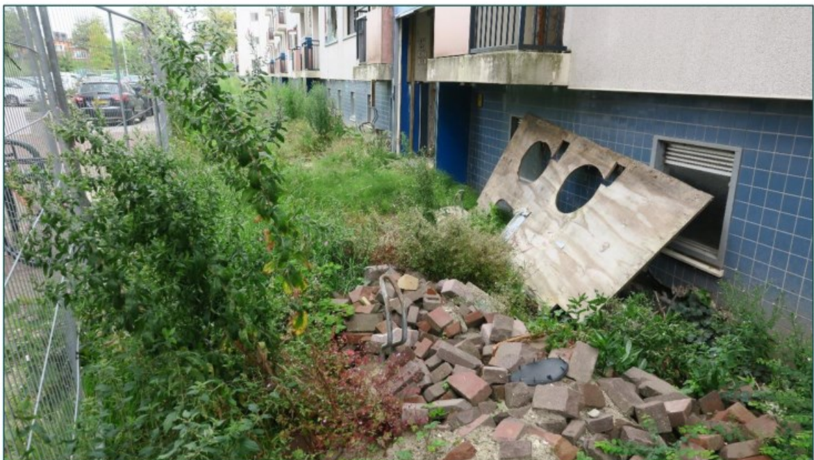
Figuur 4 De groenstrook is aan alle zijdes van de woningen aanwezig. Ook bevindt zich hier bouwmetaal.
